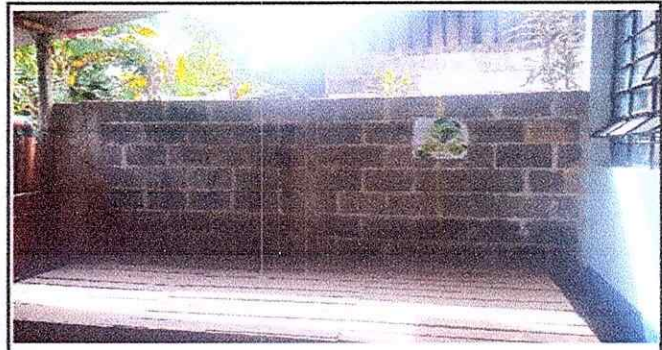
Foto 2: esta parte nos sirve de escenario en las actividades con los niños. Y se cubrira una parte descubierta en el otro extremo del muro.
