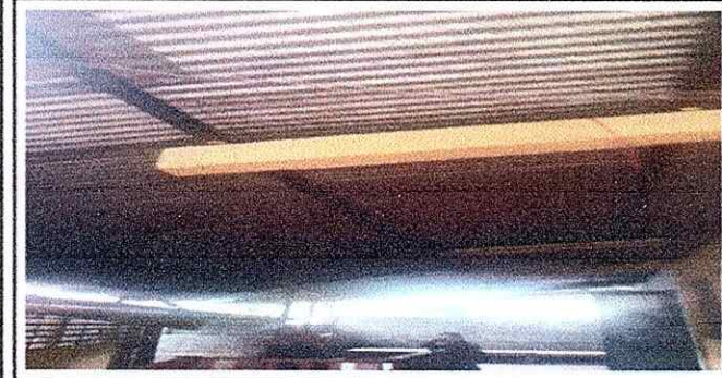
Foto 3: se cambiara parte del techo del corredor y se asegurara mas ya que en la actualidad, el techo esta inseguro.
